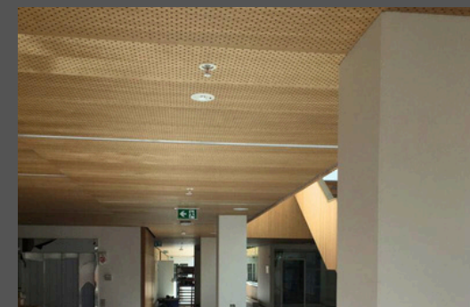
Korridorloft i skjult skinneresystem. Eg.
